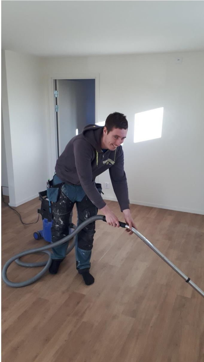
Emil Petterson hos entreprenören Hjertstedts bygg gör den sista grovstädningen innan det är dags för finstädning.
